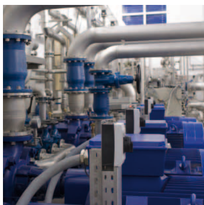
Controllo di Pompe Industriali
