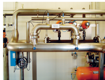
Misura di Redox e pH in tubazione
