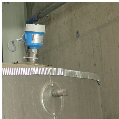
Interruttore di livello nella fase di igienizzazione: Liquiphant M
