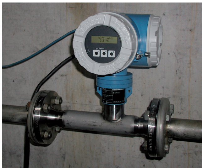
Misura della massa di biogas: t-mass installato sul lato di carico del sistema CHP
