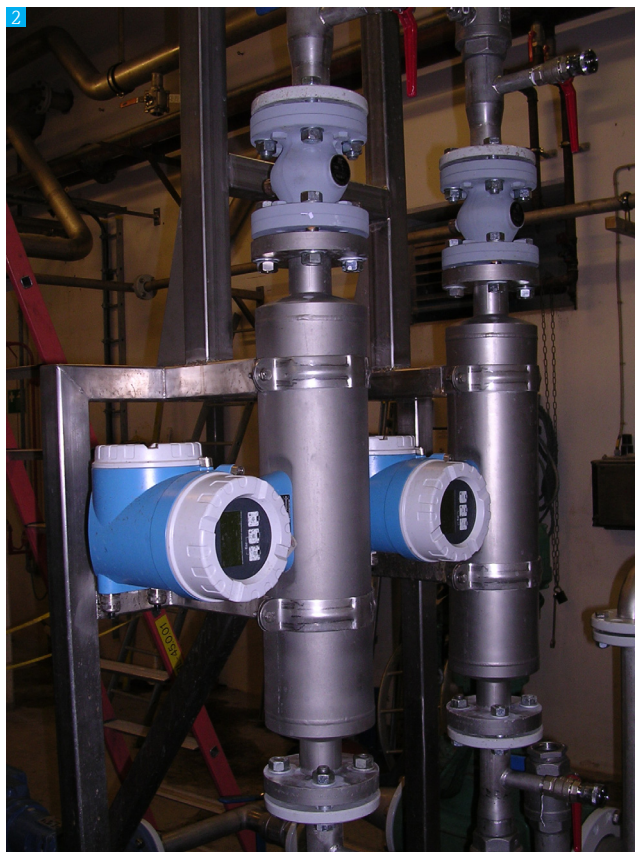
2 Misuratori di portata massica Promass 83 I per la misura del quantitativo di materiale solido secco
