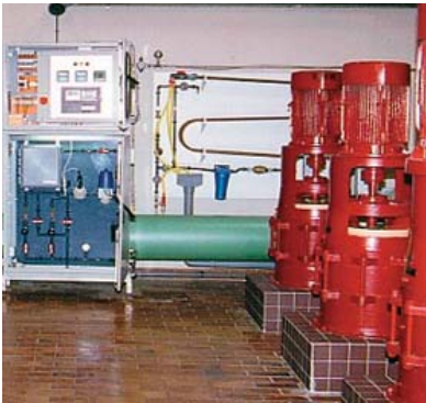
Registrazione automatica delle ore di funzionamento della pompa mediante Minilog B.
