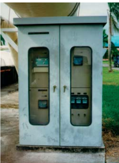
4 dispositivi Minilog B registrano l'ingresso di acqua reflua in un grande impianto di trattamento nel Sud-est asiatico.
