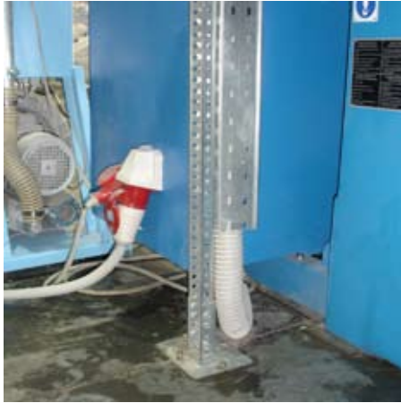
Utilizzo di SSM come piano di montaggio verticale.
